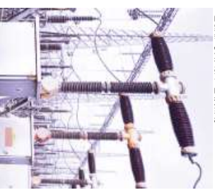
電弧局部放電檢測
